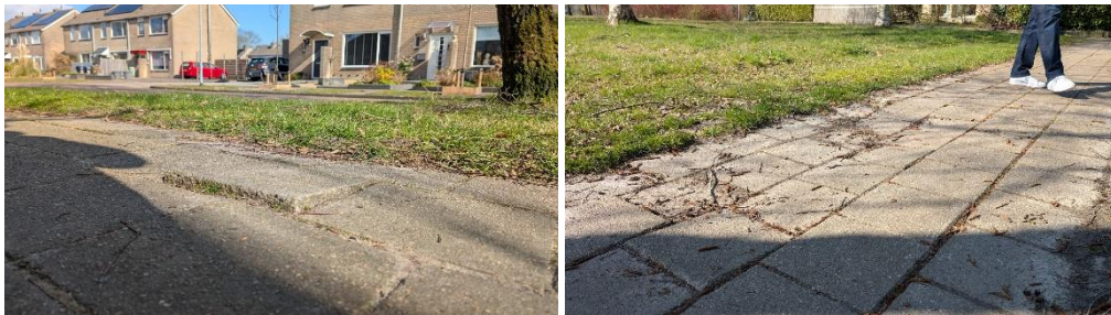
Stoep Kastelenlaan (t.h.v. nr. 147) Opstaande tegels 2x
